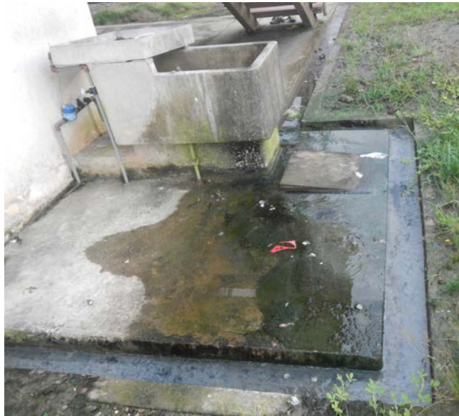
Figura 16 | Colapso de alcantarillas, 2015
