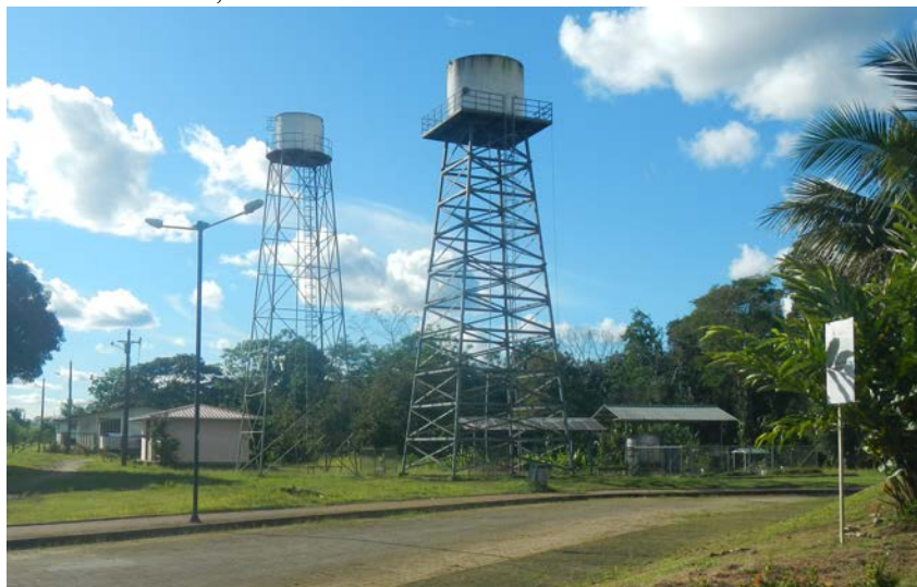
Figura 18 | Área de potabilización de agua, 2016
