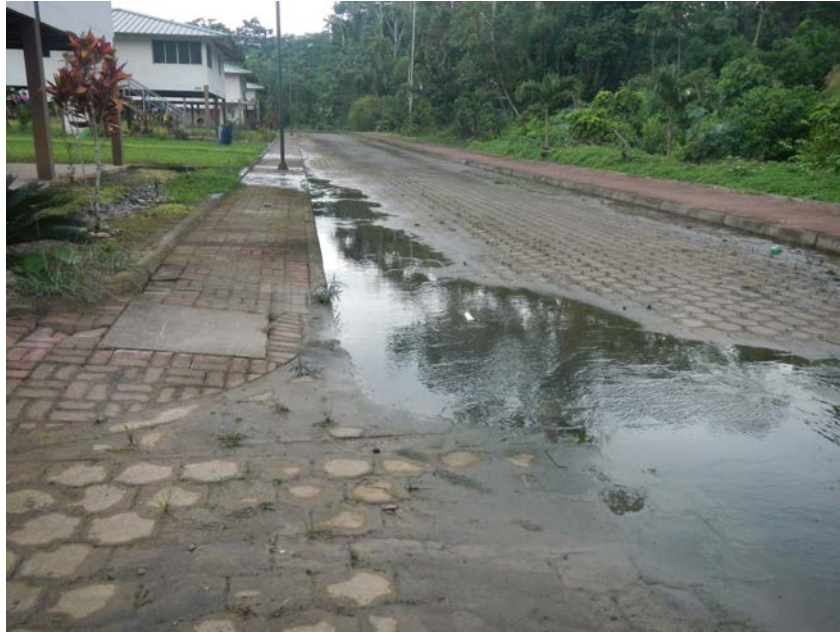
Figura 15 | Estancamiento de aguas lluvia, 2015
